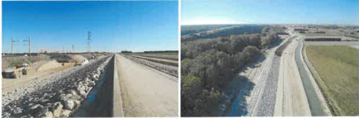
Photo 2. digues résistantes à la surverse de Tarascon-Arles et Beaucaire-Fourques (© Symadrem)
