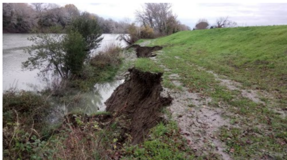
1 - Creusement de la berge sous l'effet du courant et des remous
